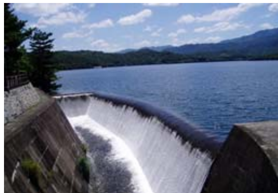
写真2：洪水吐 (香川県HPより)
