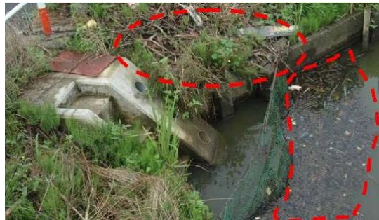
写真 38：取水部周辺の土砂やゴミの堆積
