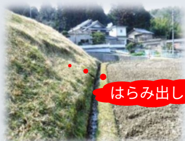
堤体のり面のはらみ出し
