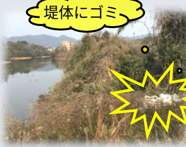
堤体にゴミ等が散乱
