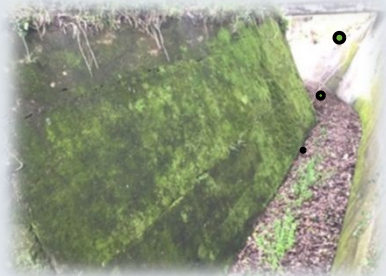
下流水路底に植物の繁茂
