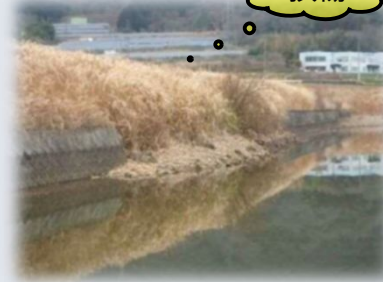
護岸ブロックの損傷
