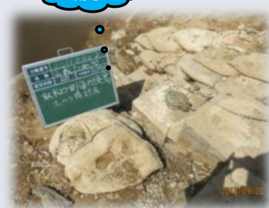
堤体との境界に隙間
