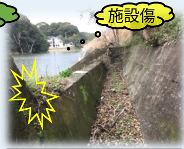
洪水吐取付部のひび割れ
