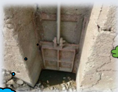
ゲート周りに漏水
