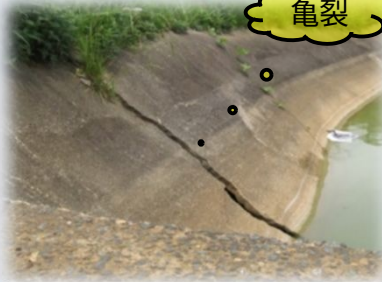
張コンに亀裂
