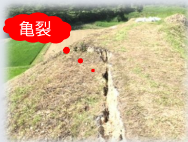
堤体の頂部亀裂
