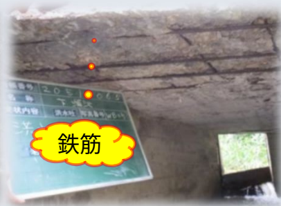
鉄筋のむき出し
