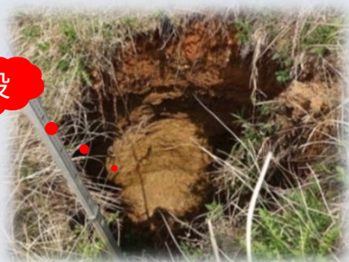
堤体の部分陥没
