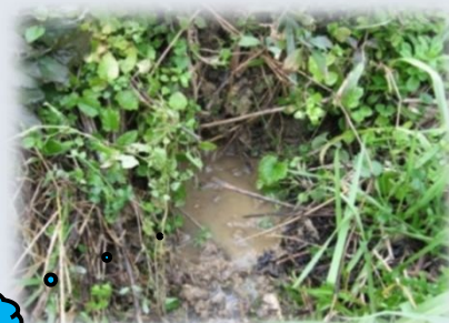
漏水の濁りと量の増大
