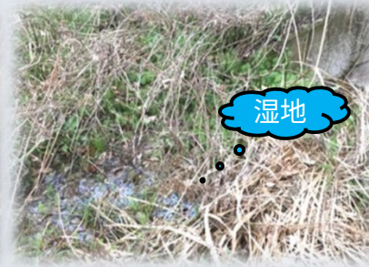
下流地盤面の湿地状況
