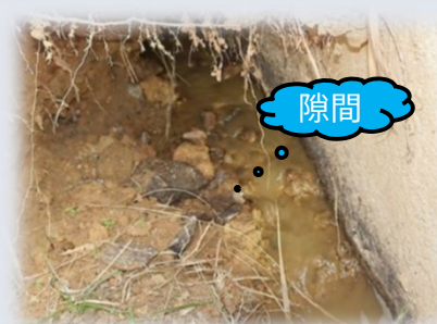
洪水吐と境界部陥没
