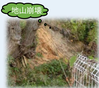
ため池周囲 土砂崩壊
