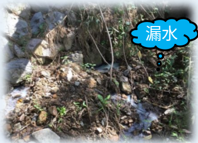
堤体の法尻からの漏水
