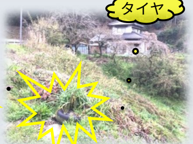
堤体に古タイヤの放置
