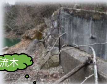
洪水吐付近に流木
