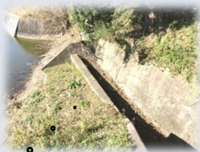
洪水吐き流入口に繁茂
