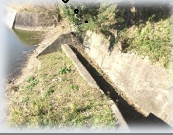
越流部に植物の繁茂
