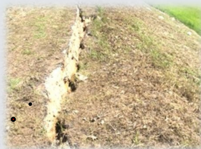
連続した亀裂
