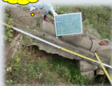
堤体との境界に隙間
