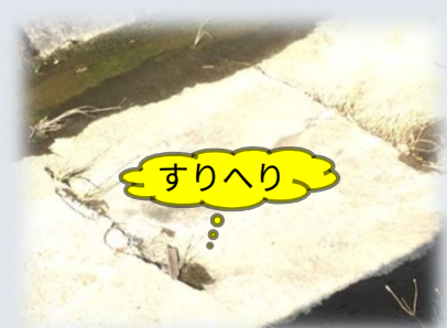
底版のすりへりと損傷
