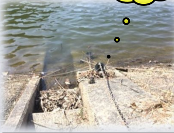
取水孔付近に流木の堆積
