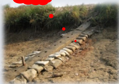
斜樋と境界部に陥没
