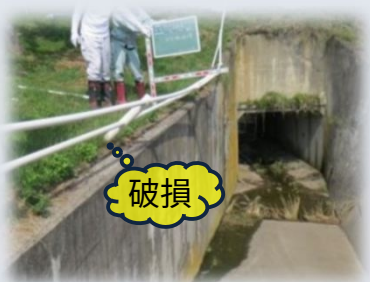
転落防止柵の破損
