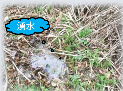
近接した法面からの湧水
