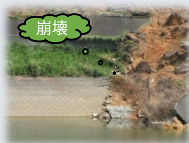
堤体法面の滑落
