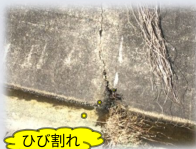
ひび割れから湧水
