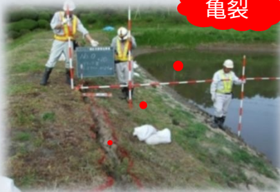
堤体頂部の亀裂
