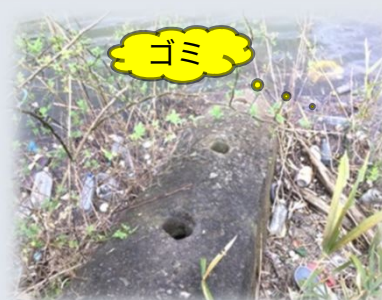
斜樋取水孔回りにゴミ
