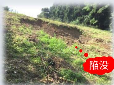
堤体法面の滑落
