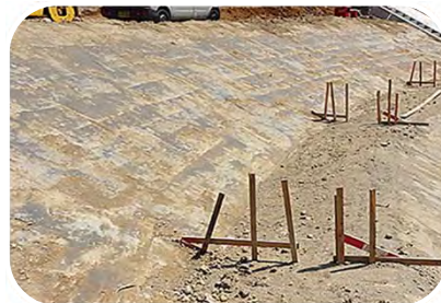
余盛を削取った後は筋状の転圧履歴が確認できます
