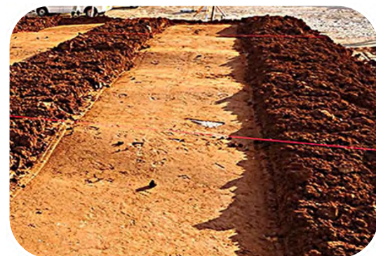
転圧面が波打つ状況
