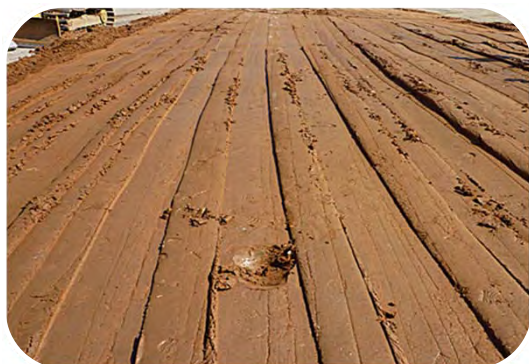
含水比過大による過転圧
