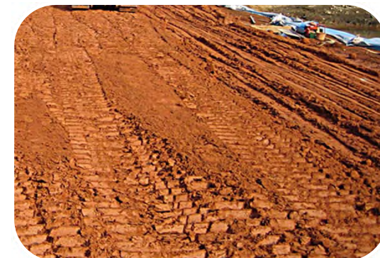
含水比過大による過転圧及び刃金土選定ミス
