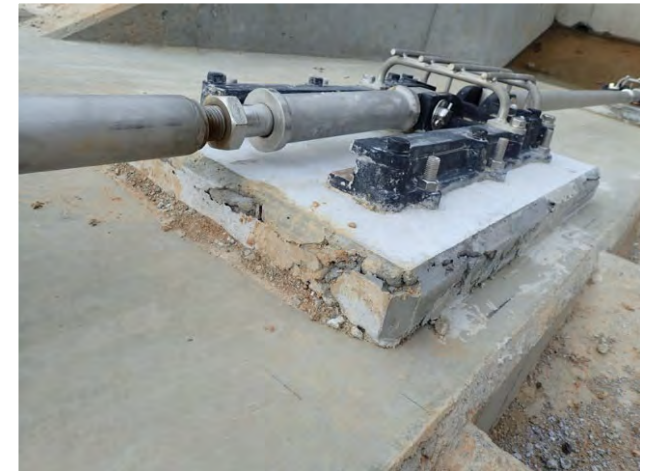
箱抜きがない事例
