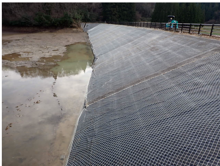
農村地域防災減災事業で設置した安全ネット
