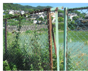
安全柵の破損状況
