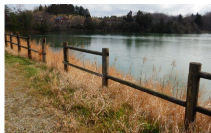
安全柵の破損状況
