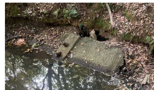
【堤体土の流亡】
