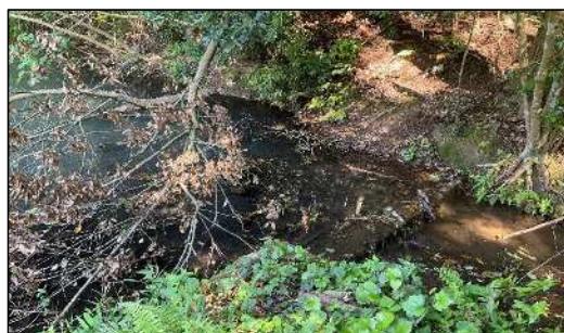
【洪水吐きの通水障害（倒木）】
