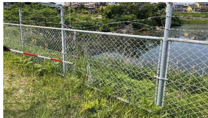
【有刺鉄線・フェンスの損傷】
