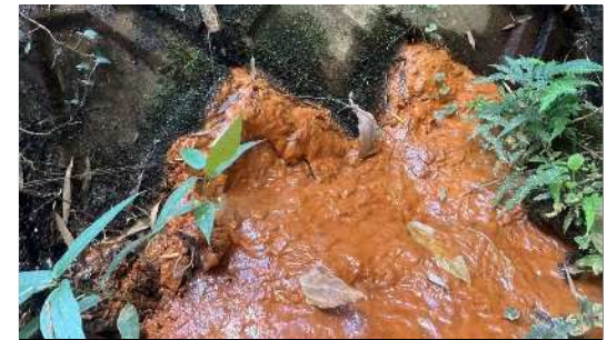
【漏水（堤体土流出）】
