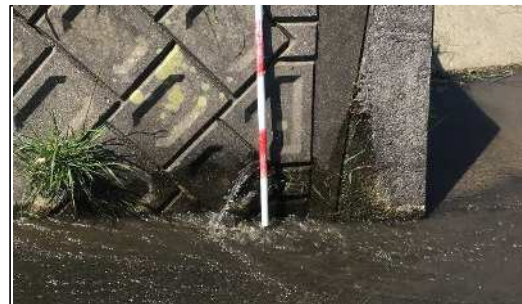
【腰石ブロックからの漏水】
