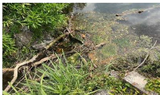
【洪水吐きの通水障害（流木）】
